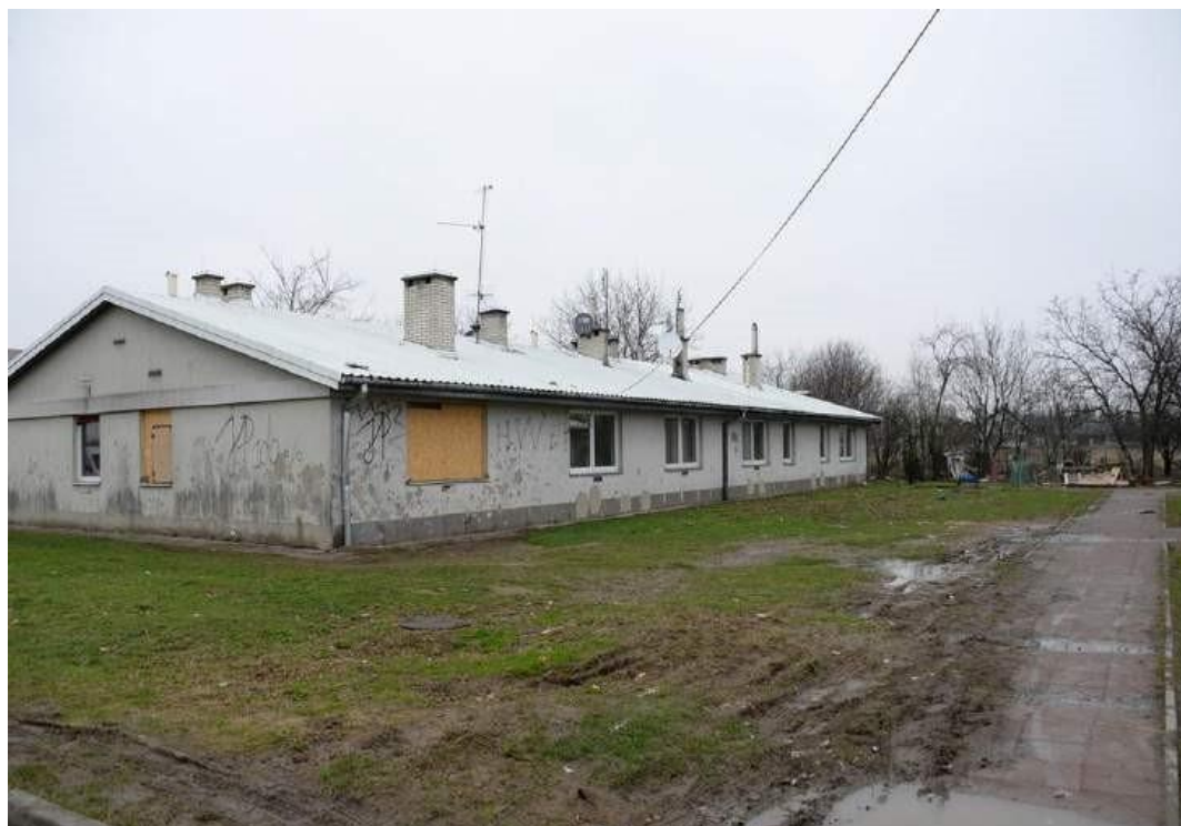
Zdjęcie nr 16 Stan techniczny jednego z budynków Osiedla Socjalnego ul. Na Buczków, fot. Łukasz Chojecki
