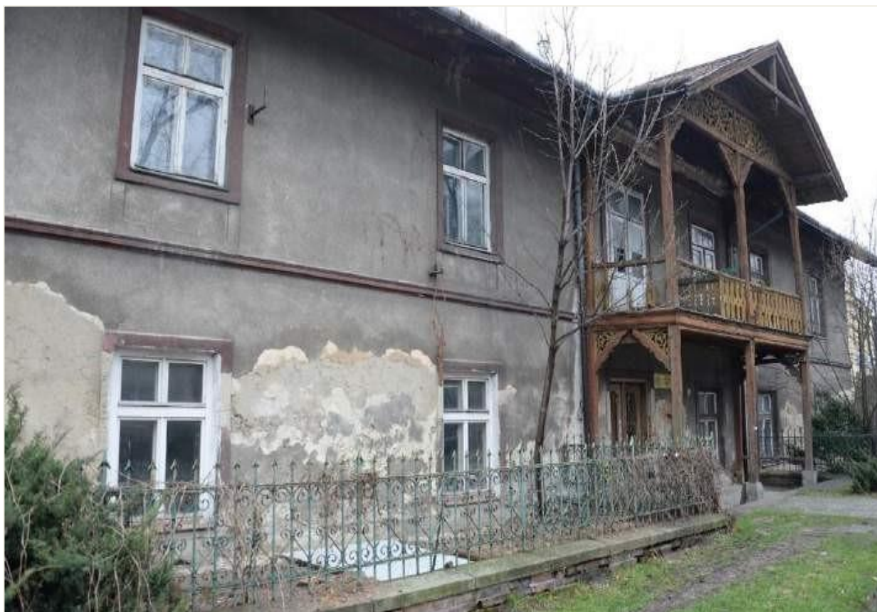
Zdjęcie nr 14 Zły stan techniczny zabytków , fot. Łukasz Chojecki
