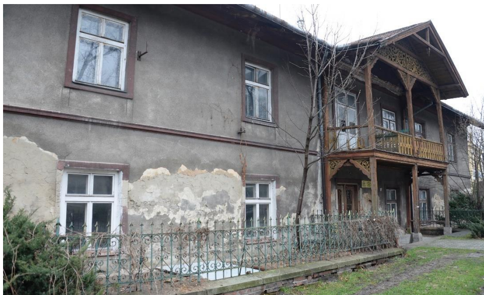
Zdjęcie nr 1 Zły stan techniczny zabytków
