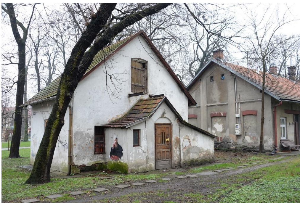
Zdjęcie nr 2 Zły stan techniczny zabytków
